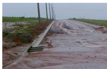
Figura 30 - Carreamento de solo em obras de loteamentos
